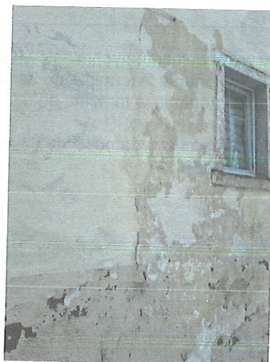
Wilgoć na ścianach, łuszcząca się farba elewacyjna
