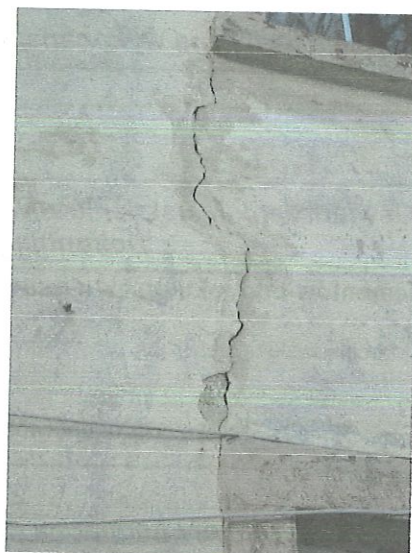
Widoczne spękania ściany
