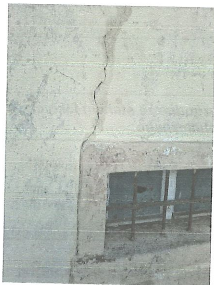
Widoczne spękania ściany
