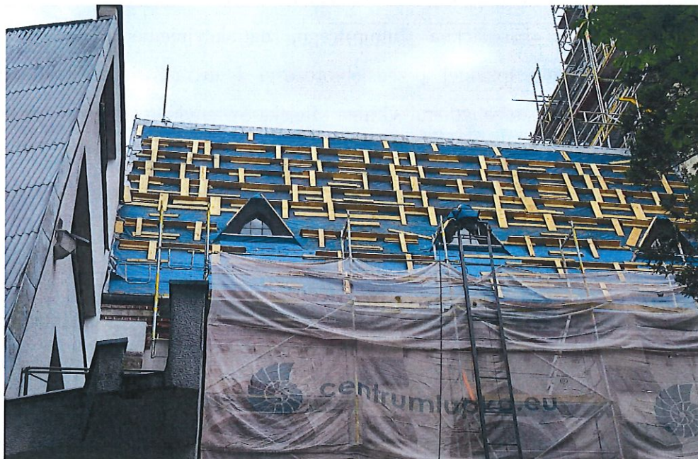
Fot. 1. Remont pokrycia dachu głównego w kościele pw. św. Jana Oblubieńca NMP.
