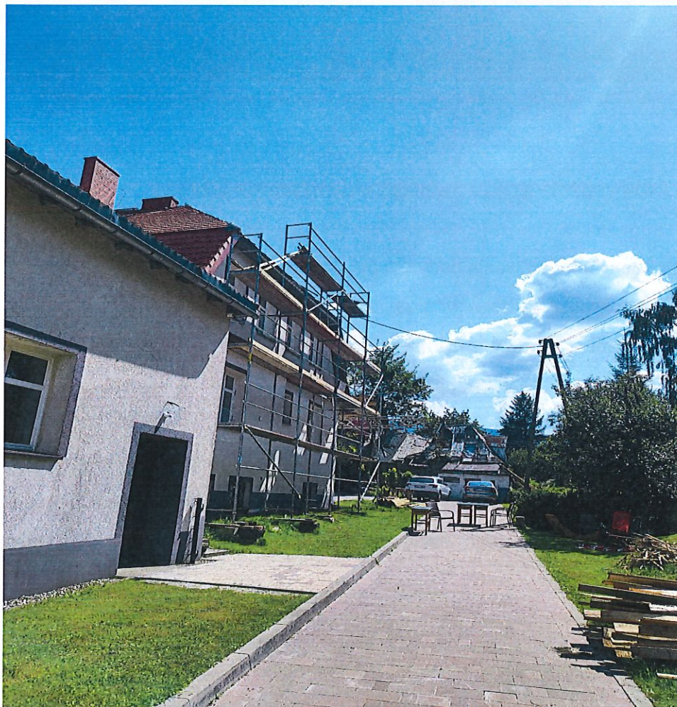
Fot. 2. Remont pokrycia dachowego z termomodernizacją budynku parafialnego przy kościele pw. Podwyższenia Krzyża Świętego.
