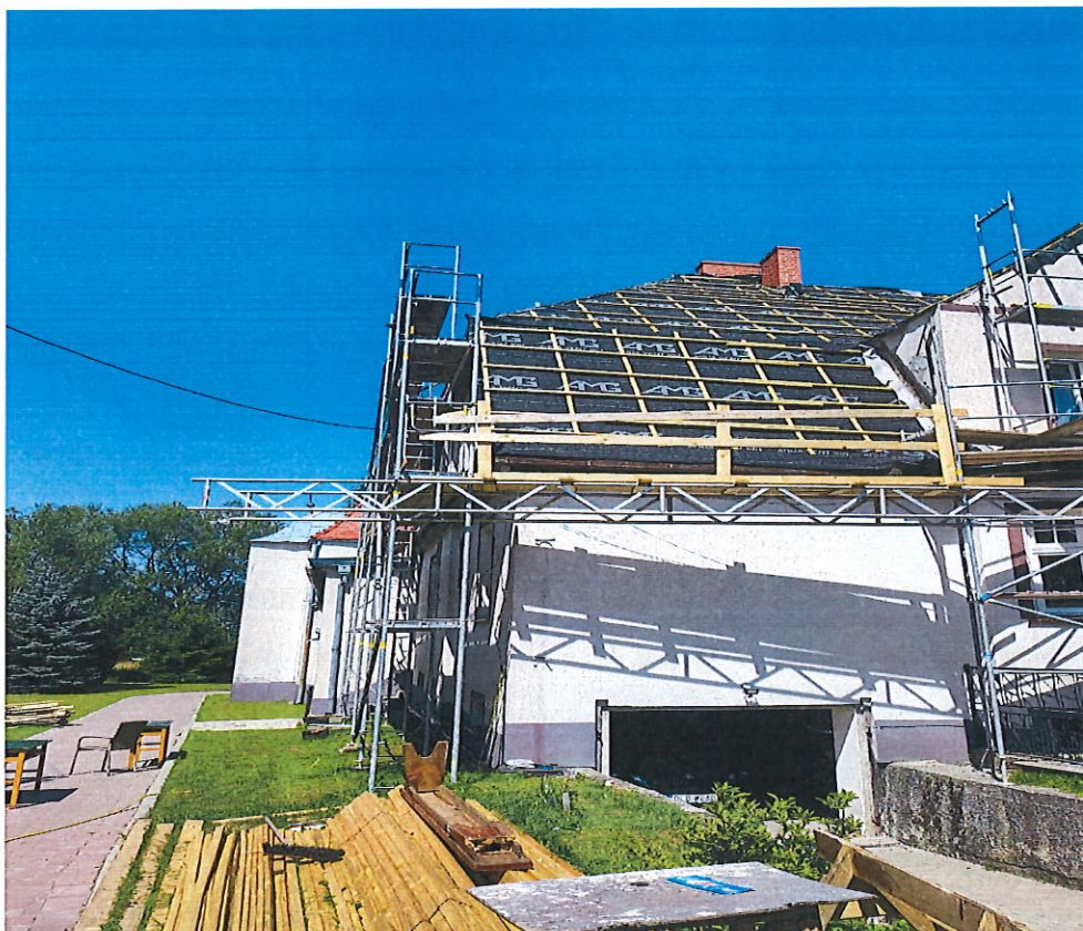
Fot. 3. Remont pokrycia dachowego z termomodernizacją budynku parafialnego przy kościele pw. Podwyższenia Krzyża Świętego.
